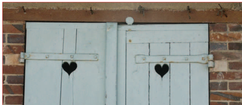
Jour de ventilation en forme de cœur
