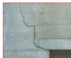
Enduit ciment sur une maçonnerie ancienne : fissurations
