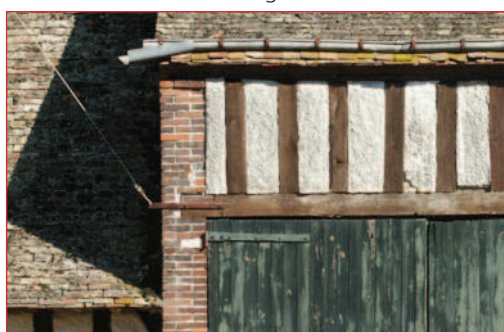
Colombages protégés par un lait de chaux.
